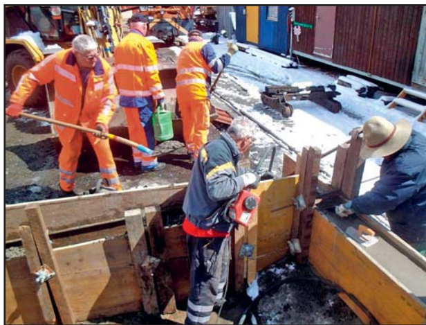
Bauarbeiten wie hier am Stützpunkt Realp oder an Stützmauern sind häufig gefragt
